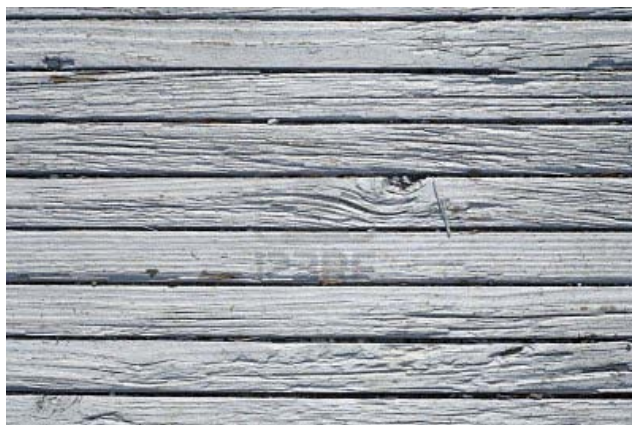
Figura A.11: Fusta fortament degradada per l'acció del Sol.
